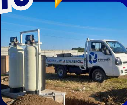
INSTALACIÓN DE SISTEMA DE ABLANDADORES
